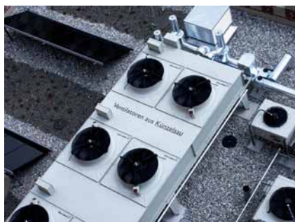
Verflüssiger mit Axialventilatoren
