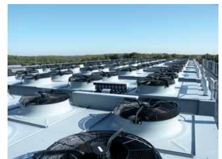
Verflüssiger mit Axialventilatoren
