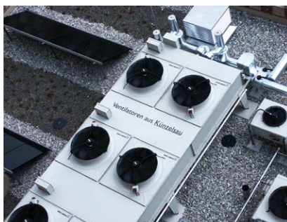
Verflüssiger mit Axialventilatoren
