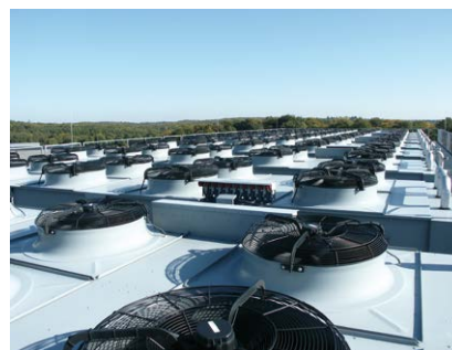
Verflüssiger mit Axialventilatoren
